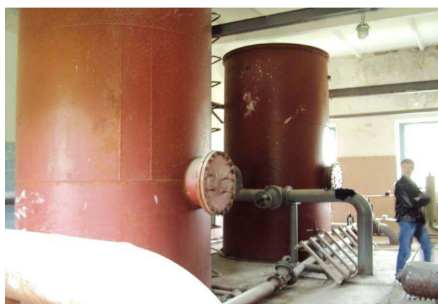
Рис. 12. Фильтры для доочистки сточной воды с песчаной загрузкой
