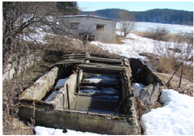
Рис. 28. Разрушенное емкостное сооружение КОС пос. Ласанен
