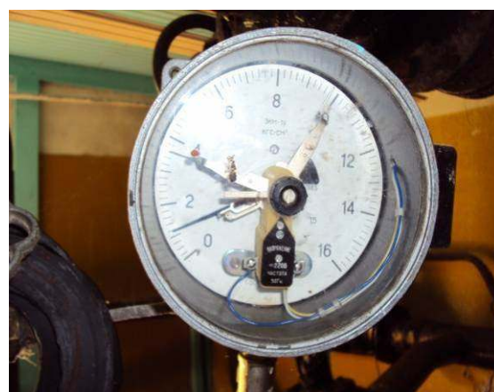
Рис. 4. Манометр на выходном трубопроводе
