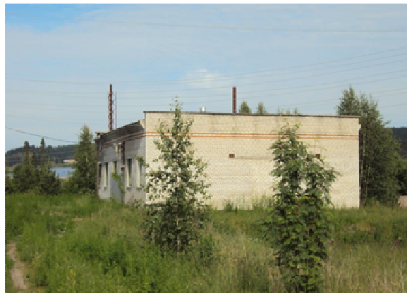
Рис. 16. Здание КОС, в котором установлено электро-механическое оборудование
