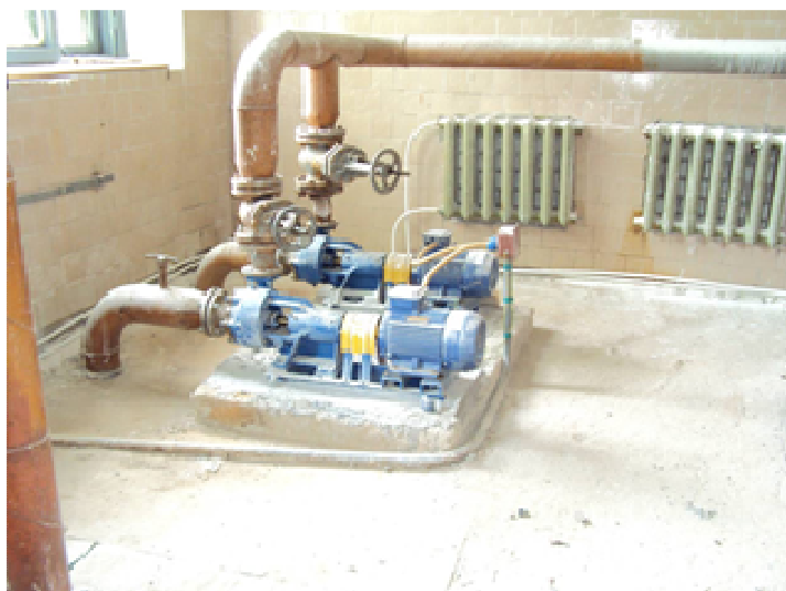
Рис. 14. Центробежные насосы для водо-воздушно промывки песчаных фильтров
