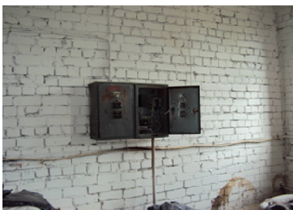
Рис. 17. Пульт управления воздуходувными агрегатами аэротенков
