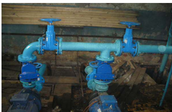
Рис.23. Новое насосное оборудование (Залив Риеккаланлахти)
