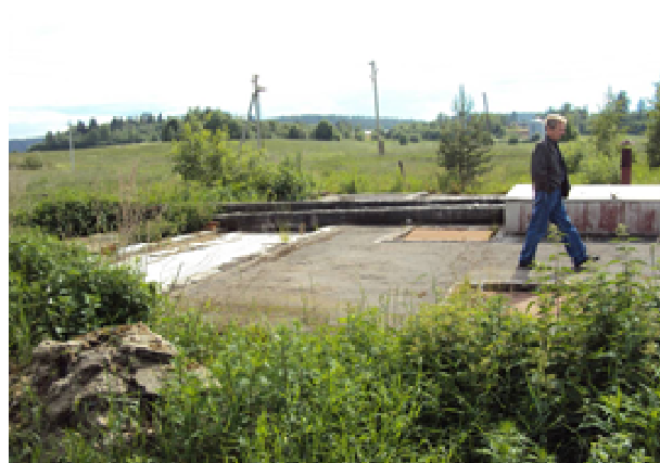
Рис. 18. Выпуск не очищенной сточной воды на рельеф местности (ближайший трубопровод)
