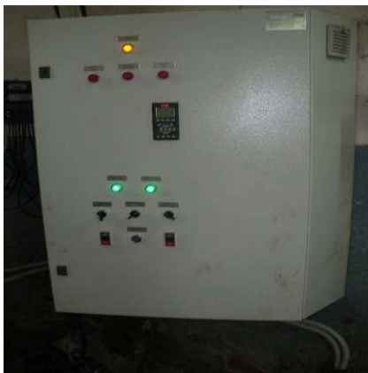
Рис. 25. Шкаф управления с частотным регулированием насосных агрегатов (Залив Риеккаланлахти)
